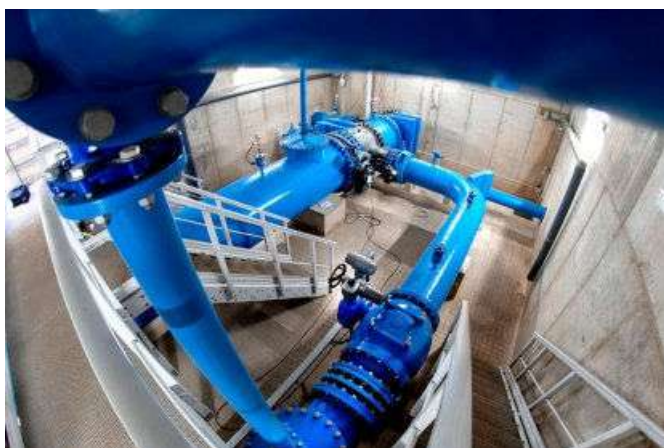
Tuberías de red del alcantarillado
