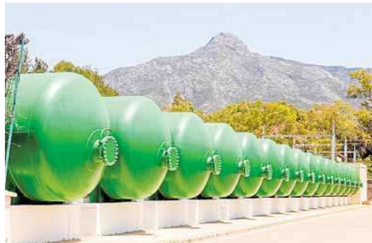
Los nuevos filtros de arena. SUR
